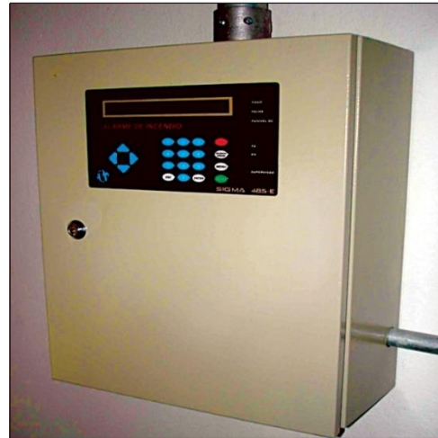
Figura 50: Central de alarme de incêndio
