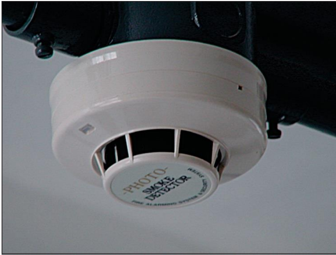
Figura 47: Detector de incêndio
