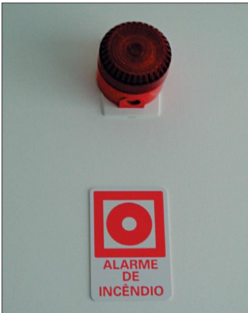
Figura 49: Detalhe de sirene
