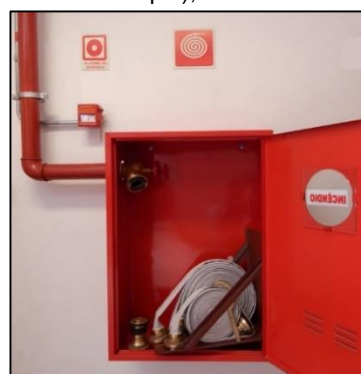
Figura 55: Detalhe de hidrante
